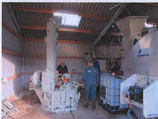
Figuur 7 Opbouw stikstofstripper op proefboerderij
