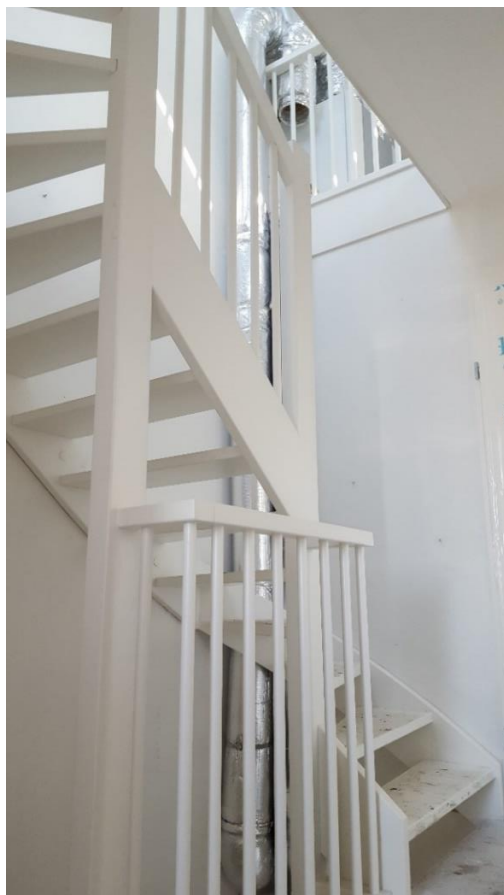
Figuur 13 afzuigkanaal in lepe hoek trappenhuis.
