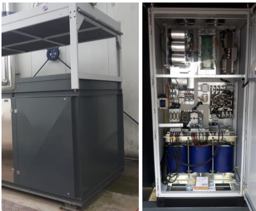
figuur 4. Kast met daarin de basiscomponenten van het lokale DC-powergrid.
