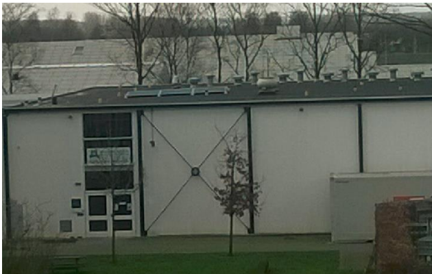
figuur 5. Dak van testfaciliteiten Phenomea voorzien van 6 stuks PV-panelen met DC-DC converters.
