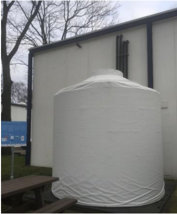
figuur 6. Geïsoleerde ijsbuffer met een capaciteit van 9 m 3 .
