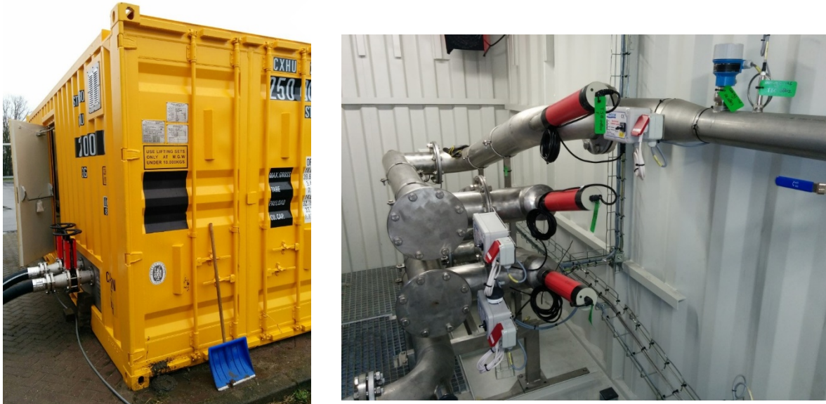
Figuur 6 TSB pilot installatie opgesteld bij rwzi Deventer
