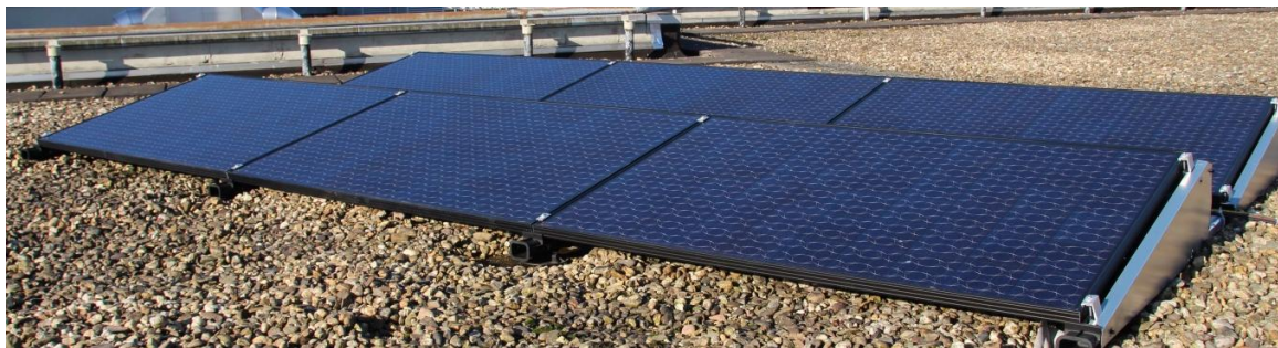
Afbeelding 3.9 MWT zonnepanelen zoals geïnstalleerd bij Witteveen+Bos
