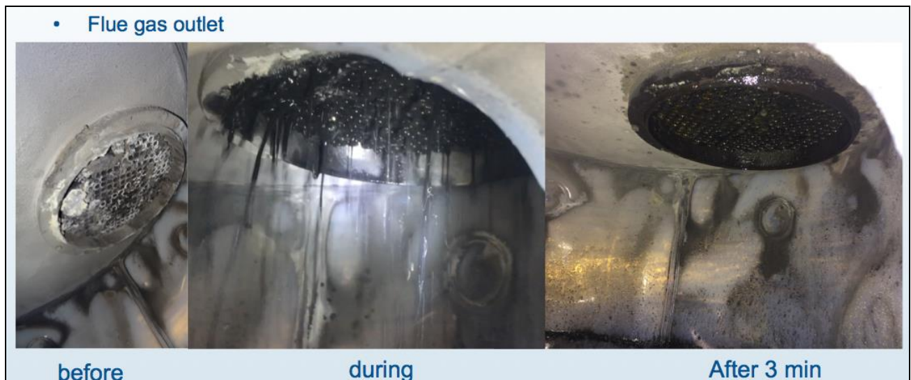
Foto 4.3: Vervuiling onderzijde bundel.
