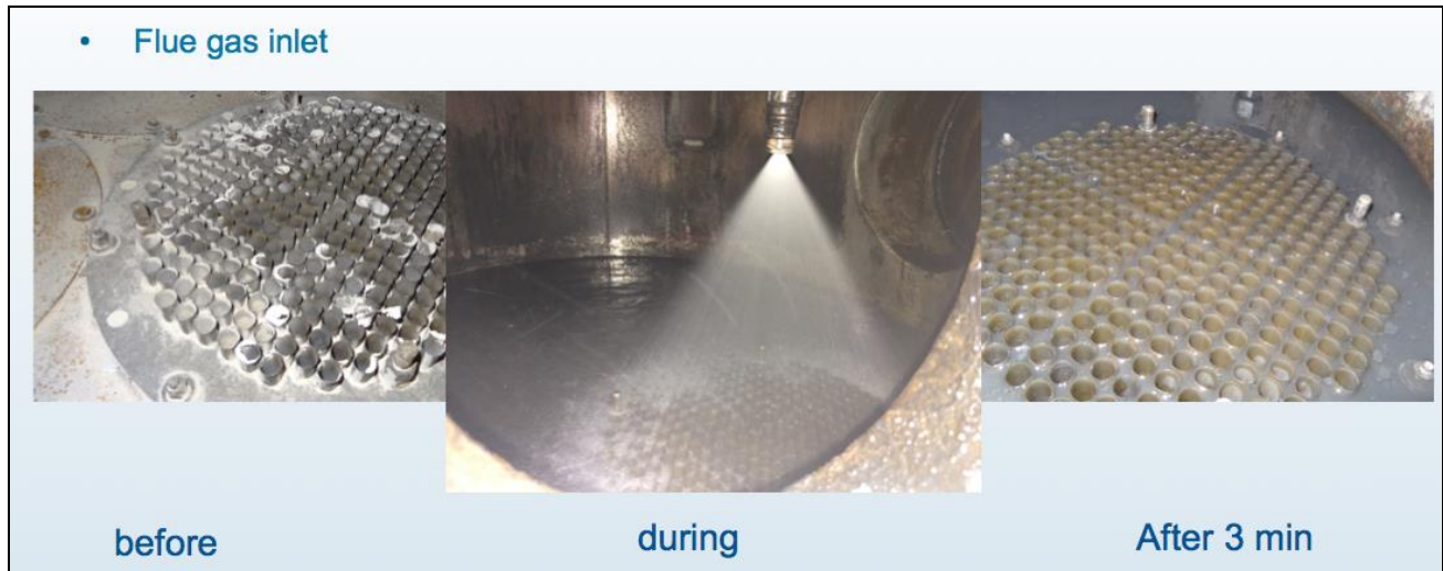
Foto 4.2: Vervuiling bovenzijde bundel.
