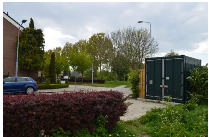
De buurtbatterij, op de kruising van de Lijzijde en de Schipperskade in Rijsenhout. (Bron: Liander)
