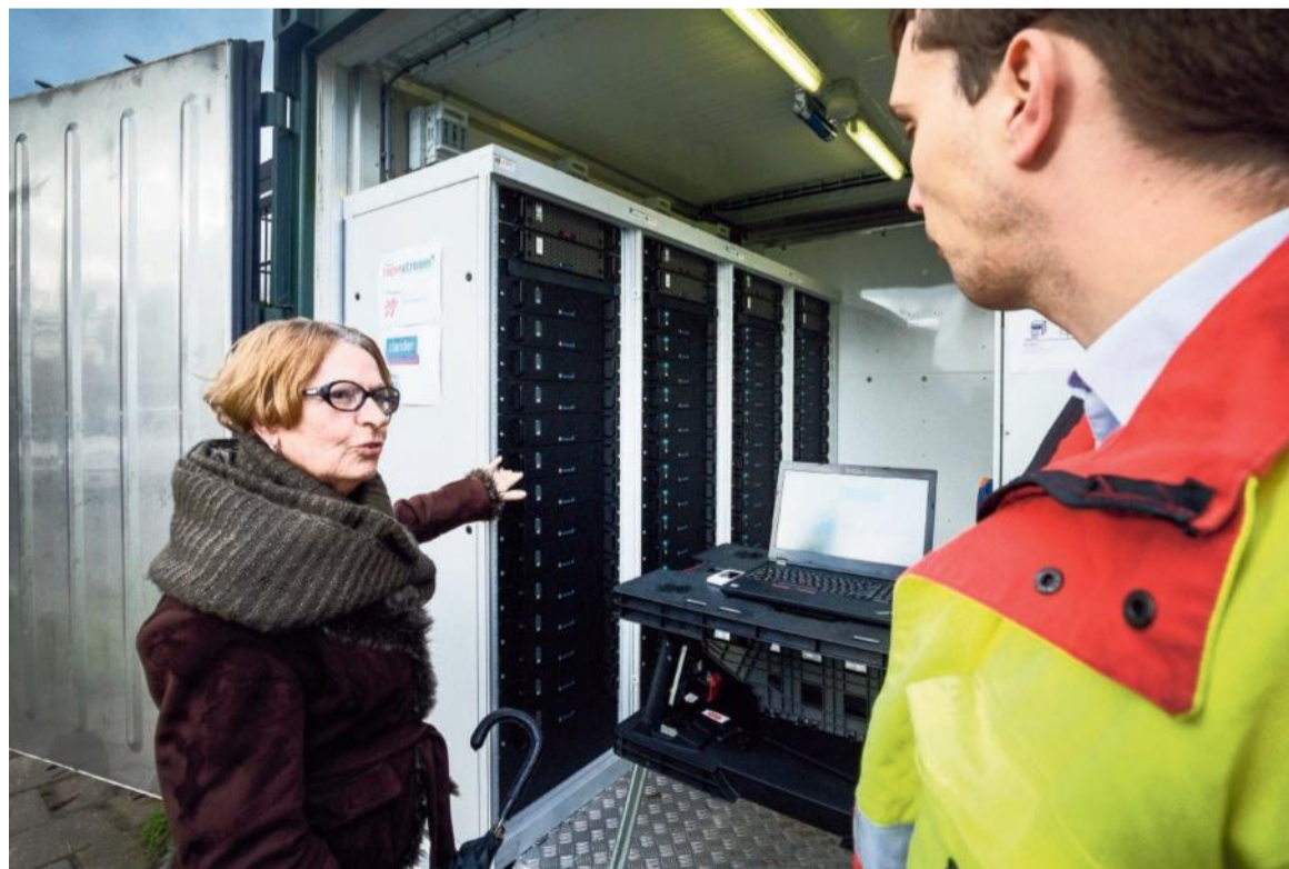
In het dorp Rijsenhout in de Haarlemmermeer wordt een 'buurtbatterij' geïnstalleerd. De batterijen (à 140.000 euro) slaan zonne-energie uit de wijk op.
