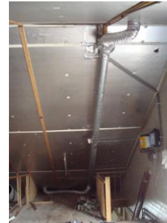
Fig 1b) Ventilator en meetopstelling aan de binnenzijde van het dak
