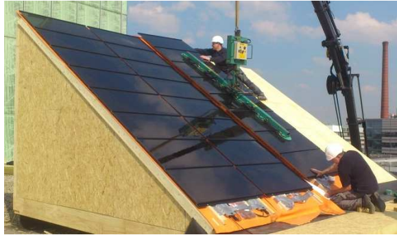
Figuur 6 Het monteren van de het product prototype op het proefdak in mei 2014.
