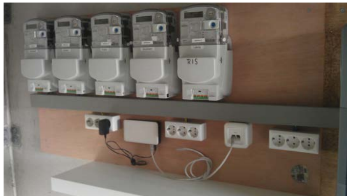
Figuur 26: Slimme meters in technische ruimte
